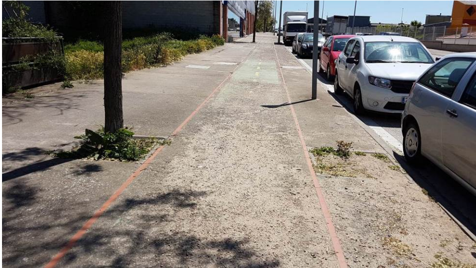
Fotografia 4.4.2.7 - Paviment en mal estat carrer de la Vila
